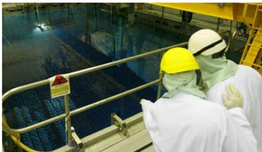
Dos operarios observan una piscina donde almacenan los residuos radioactivos en Garoña
